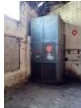
Transformateur électrique (bâtiment B5)
